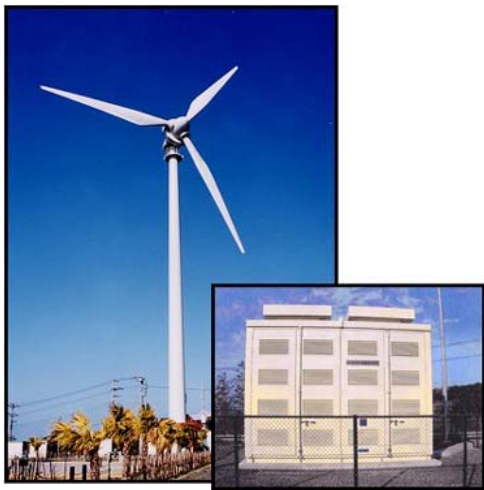
그림 9. Hachijo섬에 설치된 풍력발전과 NaS 전지
